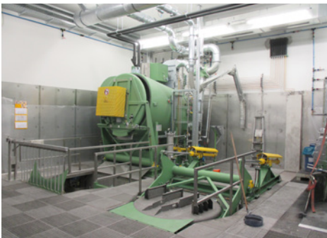
Bild 2: Die Neuanlagen zur Kesselreinigung sind seit November 2016 in Betrieb
