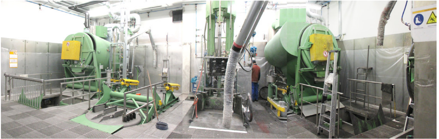
Bild 1: Kesselreinigungsraum (rechts bestehender Teil, links Neuanlagen)
